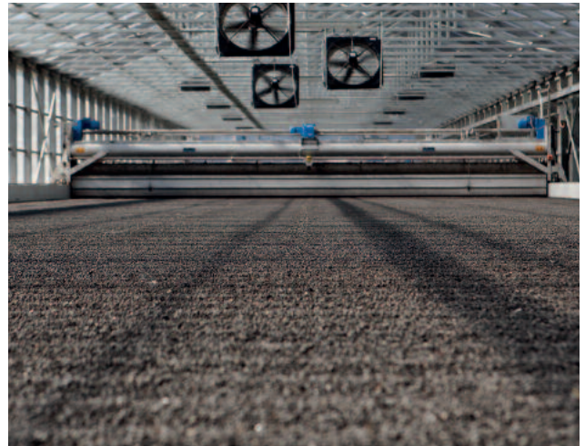
Le pont retourneur opère sur toute la largeur de la serre de façon autonome et indépendante. Les ventilateurs de brassage renouvellent l'air à la surface des boues.
