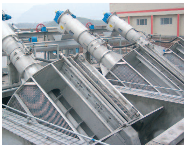
Plusieurs ROTAMAT® Ro 1 installées parallèlement dans un canal
