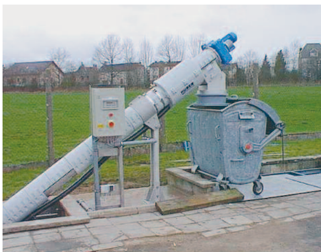
Installation extérieur d'un ROTAMAT® Ro 1 équipé de calorifugeage
