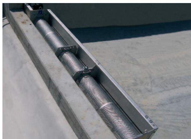
Tamiz de aliviadero HUBER ROTAMAT® RoK 2 completamente instalado.
