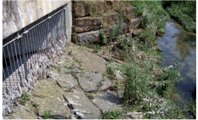
Residuos desagradables a la vista vertidos durante un evento de lluvia, típico de aliviaderos sin tamizado de material grueso.
