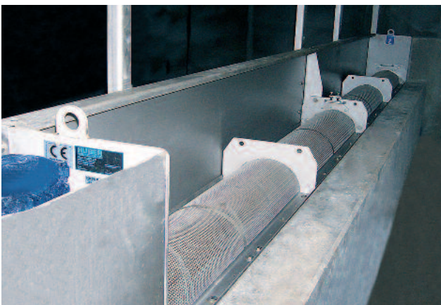
Tamiz de aliviadero ROTAMAT® RoK 2 visto desde el canal de alivio aguas abajo.
