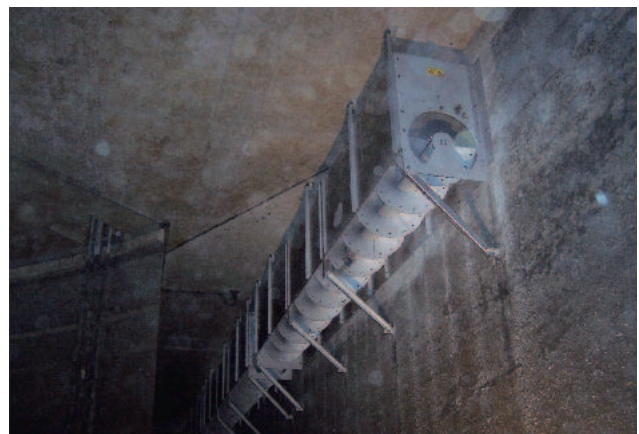
Vista lateral del tamiz de aliviadero ROTAMAT® RoK 2 desde el canal principal aguas arriba.
