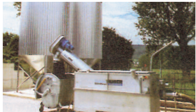
Tanques de depósito de lodo séptico permitem uma contínua dosagem de lodo e previnem uma sobrecarga
