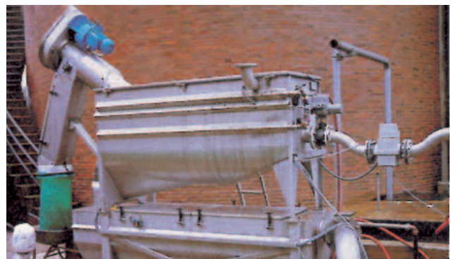
Desarenador independente para retroajuste a jusante de uma estação receptora de efluentes
