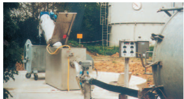
Estação Receptora de Efluentes ROTAMAT® Ro 3; instalação externa com pontos de aquecimento elétrico e isolamento térmico
