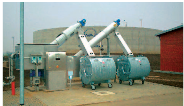
Instalação externa de uma Estação Receptora de Efluentes ROTAMAT® Ro 3.3 completa, incluindo a Peneira Fina Ro 1 e canal de areia
