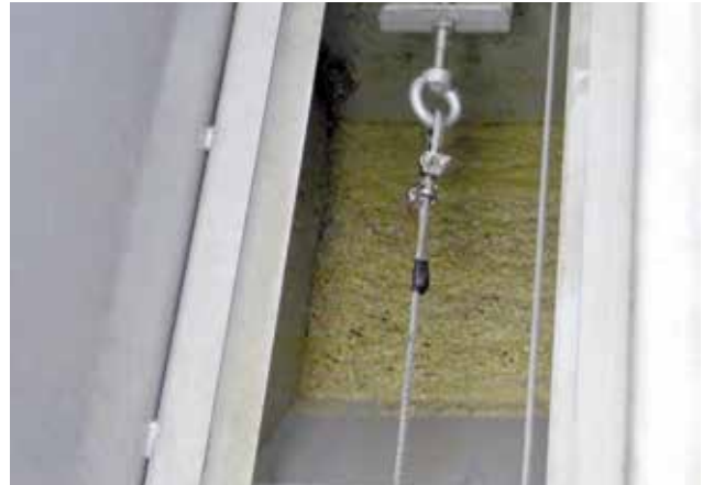
Das Fettpaddel arbeitet nach dem Prinzip eines Längsräumers, der das aufschwimmende Fett in die Pumpvorlage schiebt.
