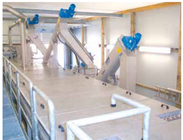
Sauberer Rechengut- und Sandfanggutaustrag bei der HUBER Kompaktanlage ROTAMAT® Ro5.
