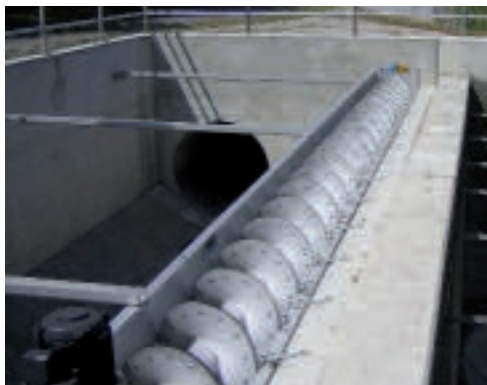
RoK 1: předčištění odpadní vody za přepadovou hranou
