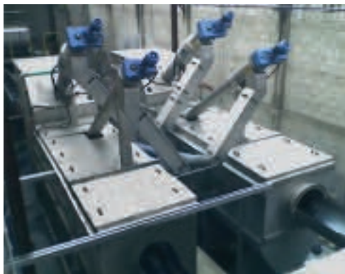
Instalace kompaktních zařízení Ro5K v textilním průmyslu (výroba džínoviny)
