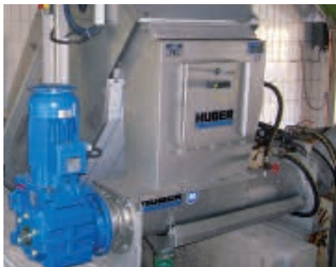
Lis na shrabky HUBER WAP, instalace za česlemi STEP SCREEN®
