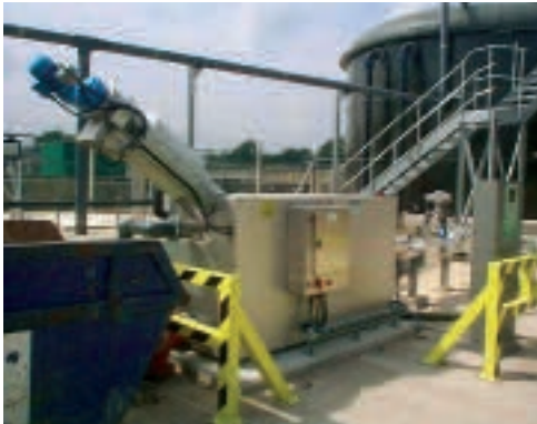
Fekální stanice - čištění kalu v provedení mimo budovu
